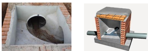
Figura 2 e 3 – Fundo das caixas de inspeção
